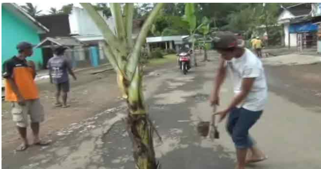
Jalan rusak di Kalipare. Sumber: Dokumentasi MCW
