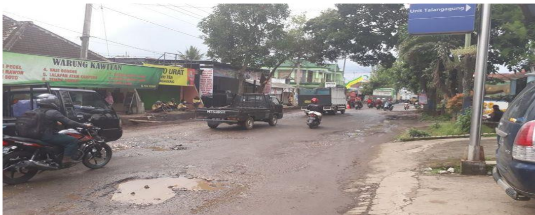
Jalan Rusak di Talangagung. Sumber: Dokumentasi MCW
